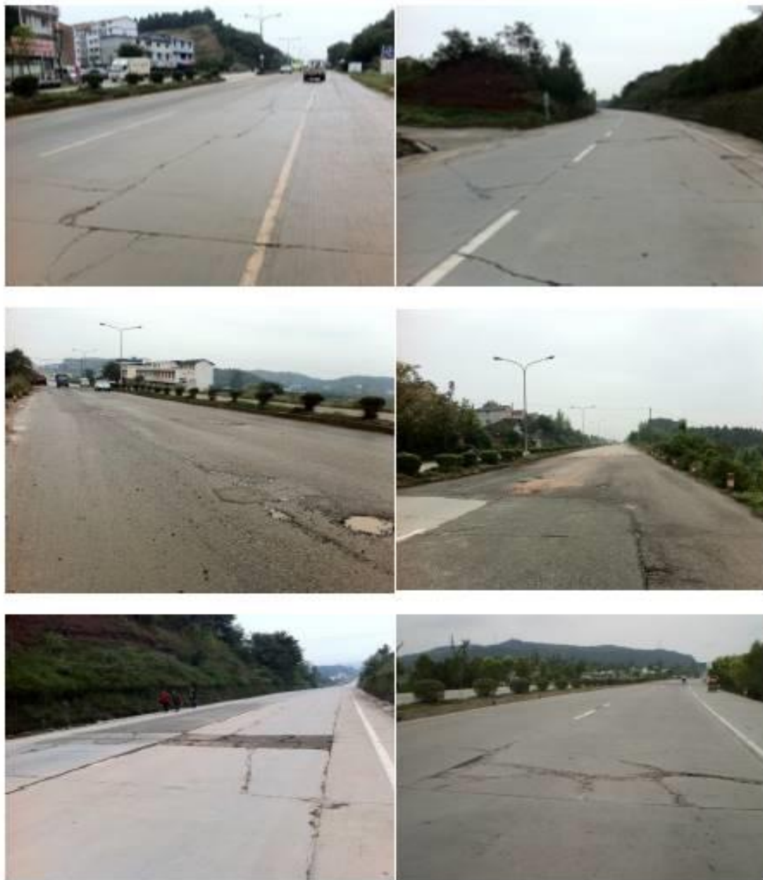
图 1-6 公路现状路面情况
