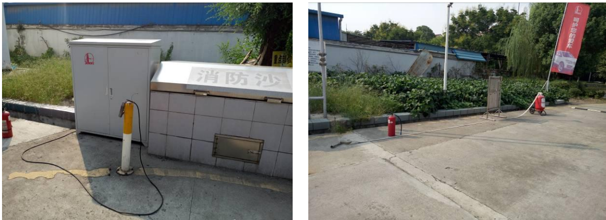
图 7-1 站内现有消防设施
