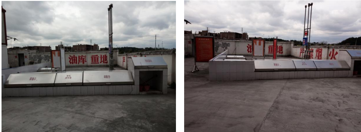
图7-1 站内现有消防设施
